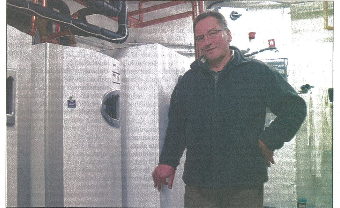
Tyytyväinen maalämpölämmittäjä. Juha Kiviniemi päätyi parisen vuotta sitten vanhassa liiketalossa vaihtamaan öljyllä lämmittämisen maalämmöllä lämmittämiseen - eikä ole hetkeäkään katunut. Investointi maksaa itsensä näillä näkymin etuajassa.
